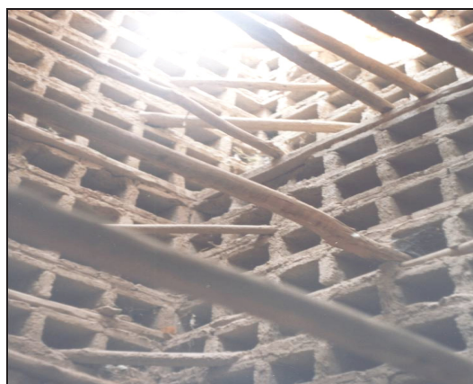
تصویر ۶. بخشی از فضای داخلی کبوترخانه نظام‌زاده (مأخذ: آرشیو میراث فرهنگی آذربایجان غربی).
